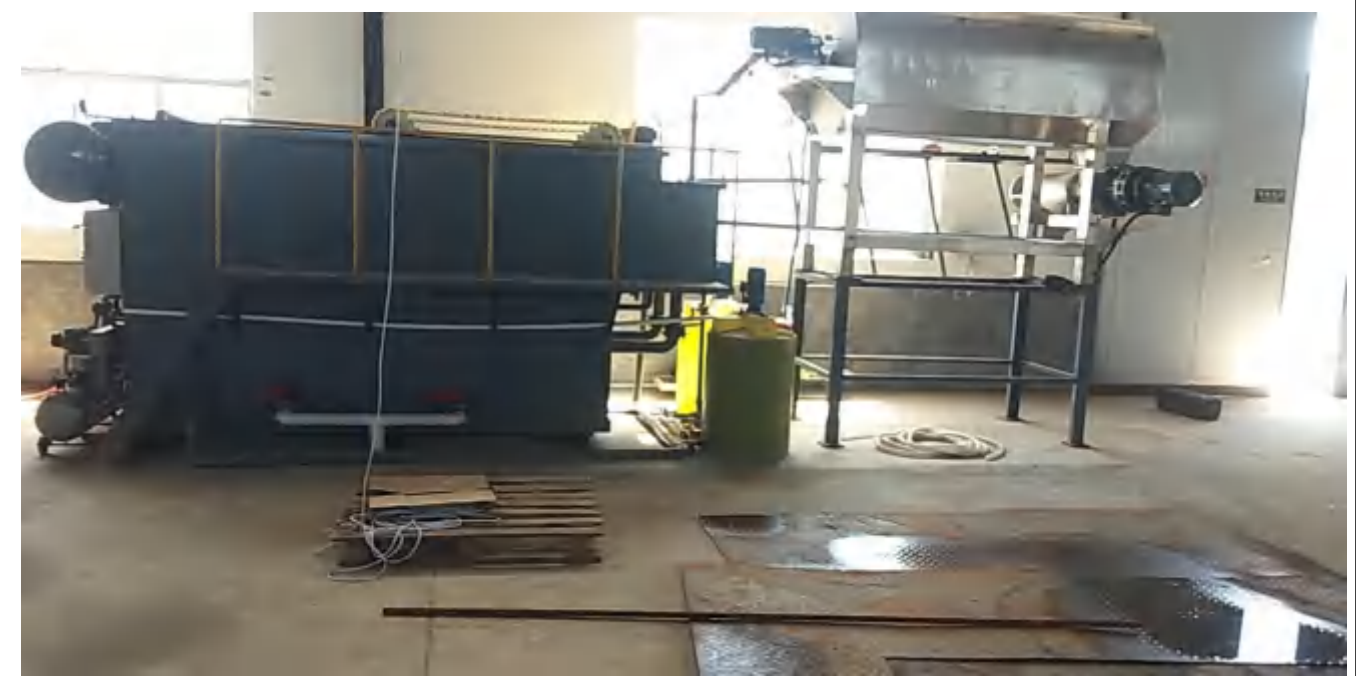
图 3-2 项目污水处理设施（从左至右为溶气气浮机、格栅纸浆分离机）
