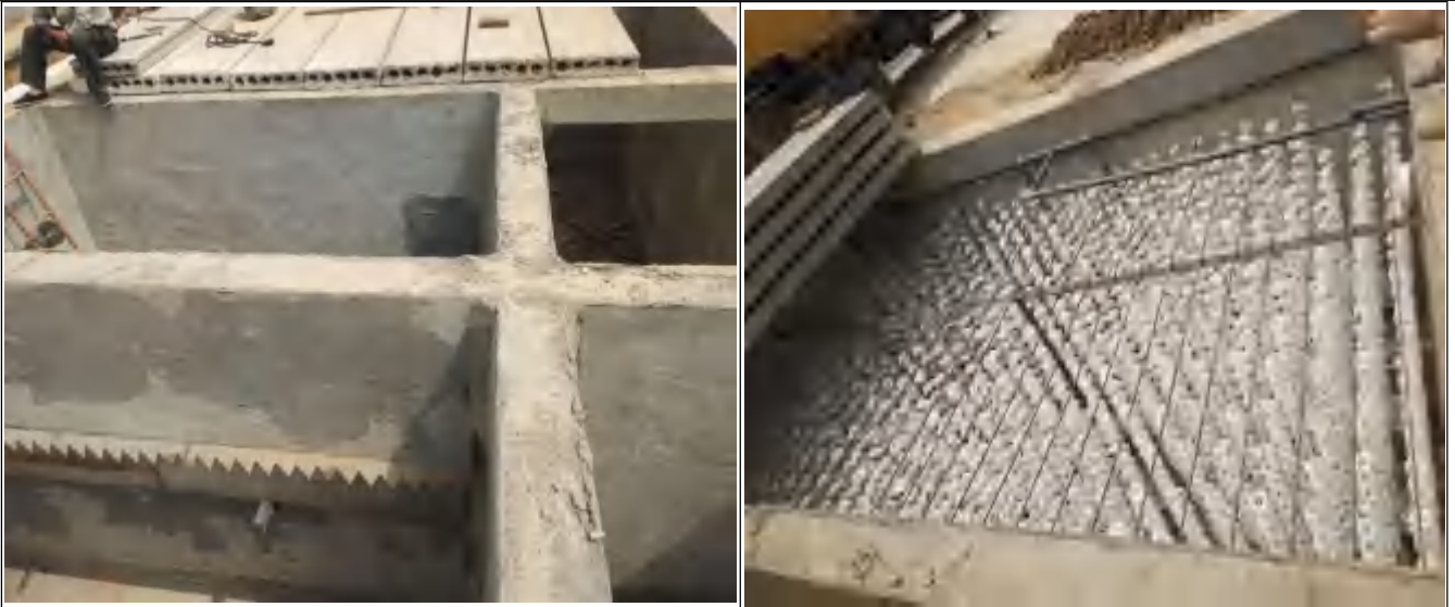
图 3-3 污水处理站内部图（从左至右为二沉池（带三角溢流堰）、接触生化池（池内布满生物填料））
