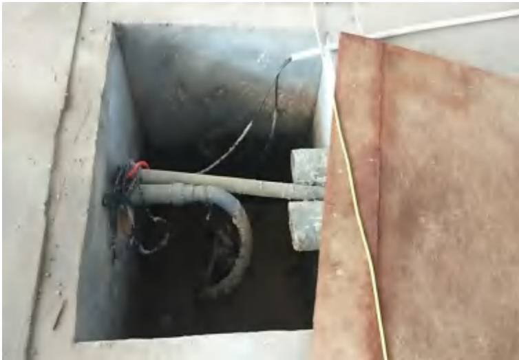
图 6-1 污水处理进口采样口
