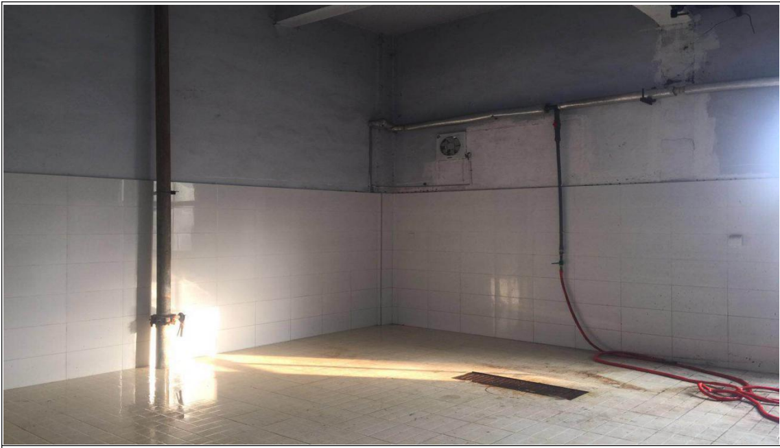
医疗废物周转箱清洗间
